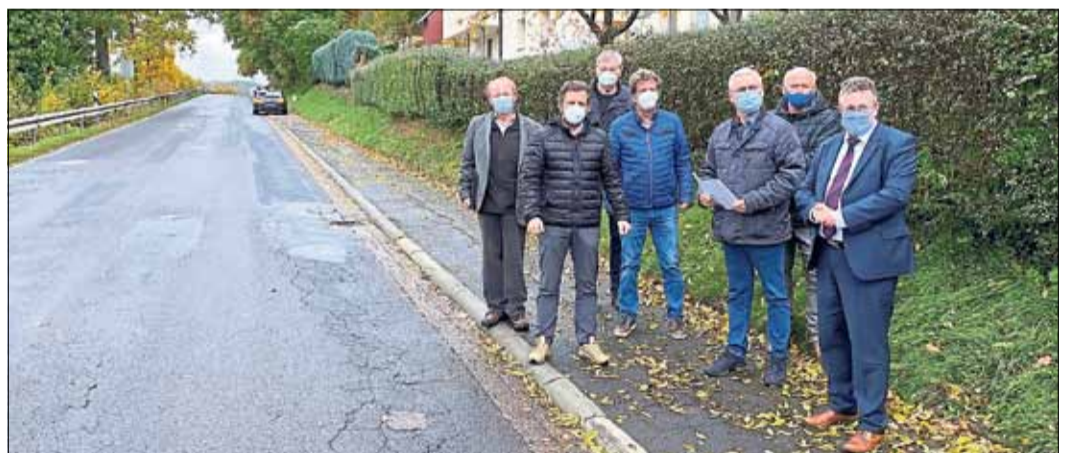
Erhebliche Straßenschäden werden auf der Romsthaler Straße in Bad Soden bald der Vergangenheit angehören. Darüber freuen sich der CDU-Landtagsabgeordnete Michael Reul, Wolfgang Heid, Hartwin Noll, Manfred Spielmann, Burkhard Kornherr, Heinrich Hausmann und Jürgen Franz. Foto: privat
